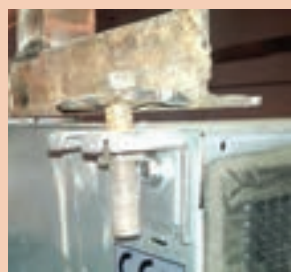
اشکال در نصب
