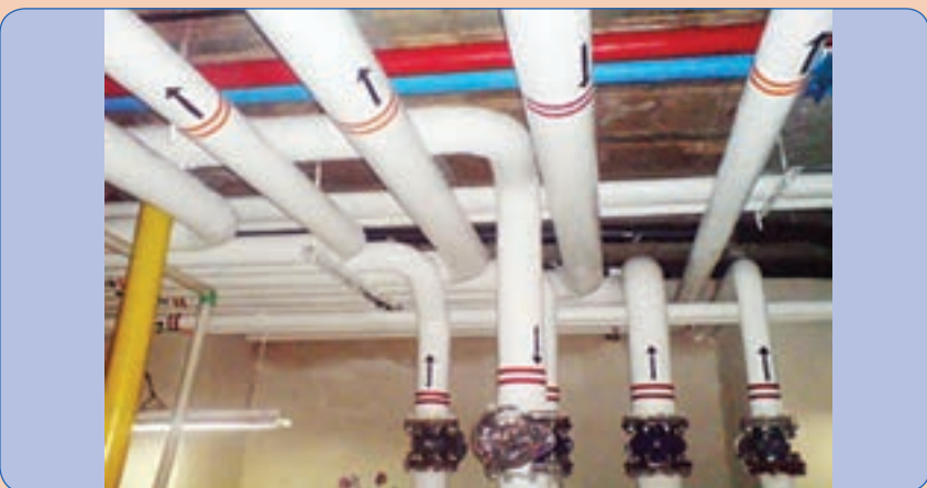
شکل ۱۳ - موتورخانه بارنگ آمیزی نهایی و فلش و نوار رنگی
