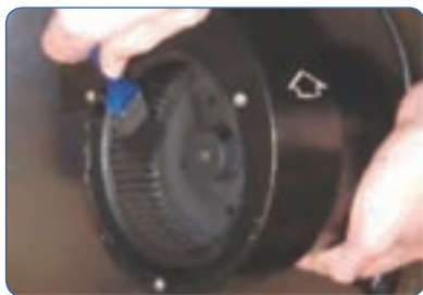
تمیزکردن فن مشعل از گردوغبار
